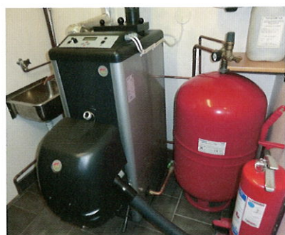
暖房・給湯のための家庭用ペレットボイラー
